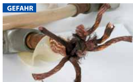
Ca. 30 Jahre alte Garnitur mit Querschnittsminderung durch Kupfer-Korrosion
