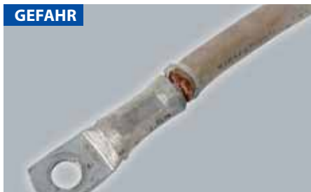
Hervortreten des blanken Leiterseils an gebrochener Seileinführung
